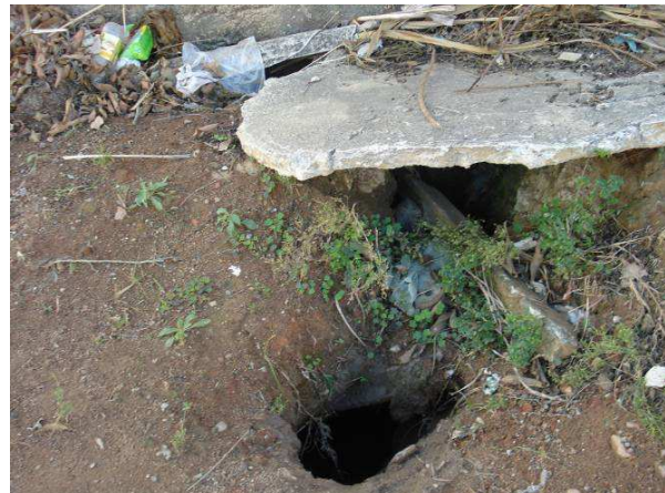
Figura 5: Fossa em estado precário. Vila Ipê Amarelo – 05/2008. Fonte: Arquivo pessoal da autora.
